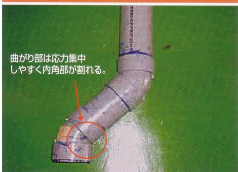
熱伸縮による破断事故例②
