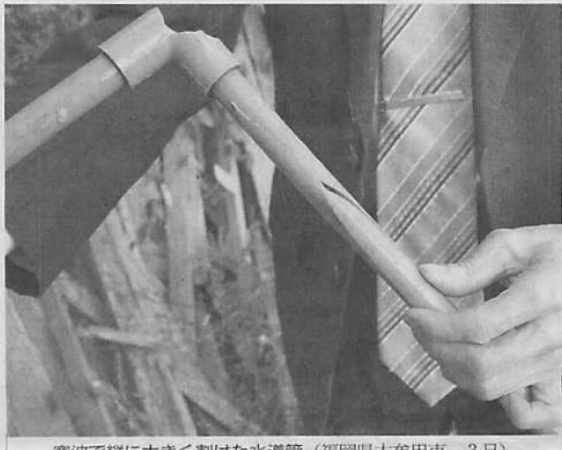
寒波で縦に大きく割けた水道管（福岡県大牟田市、3日）
